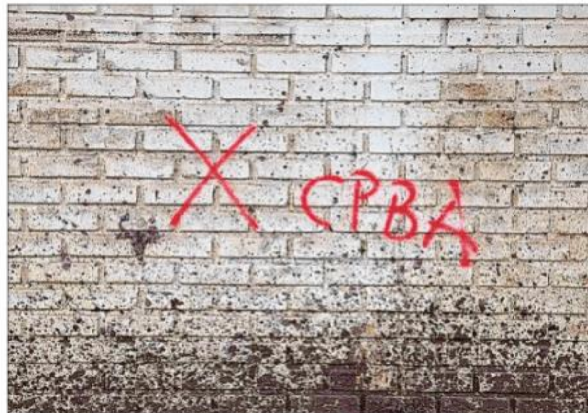
Marcas de colapso en el colegio de Massanassa. D. GONZÁLEZ / ARABA PRESS
