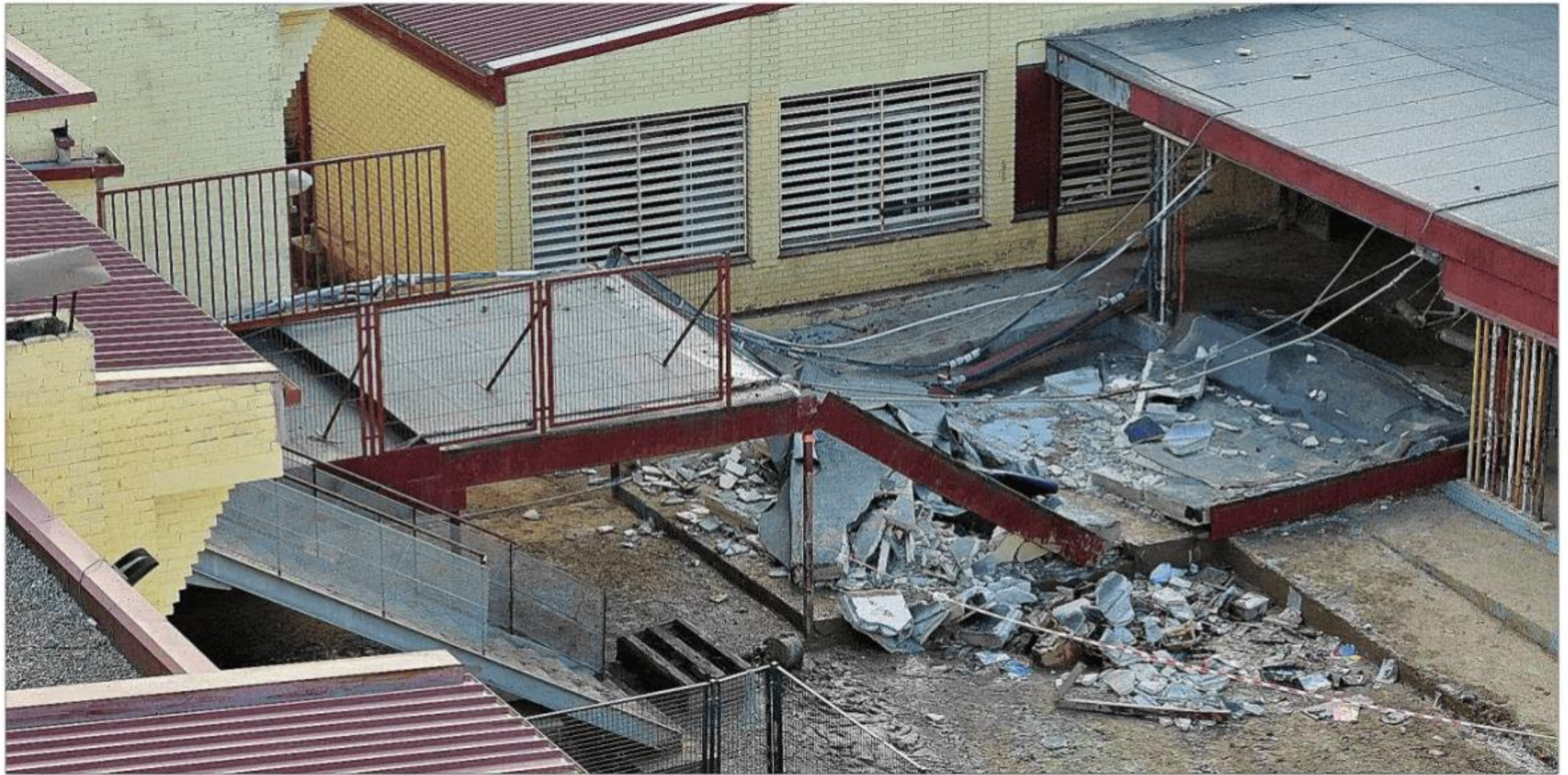
Imagen del colegio Luis Vives de Massanassa (Valencia) tras el derrumbe que se produjo el domingo a consecuencia de los destrozos de la DANA y en el que murió un operario. JOSE JORDAN / AFP
